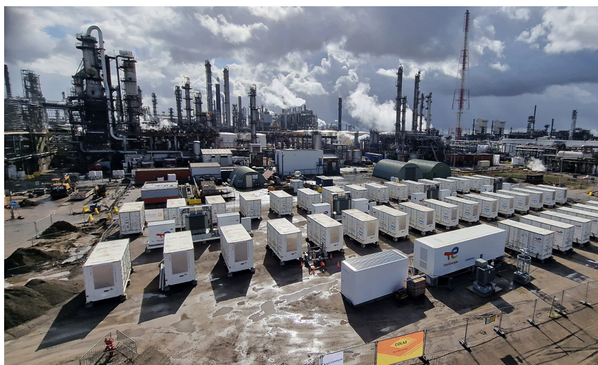
TotalEnergies triển khai dự án lưu trữ pin thứ 2 với công suất định mức là 25 MW và công suất 75 MWh ở Bỉ. Nguồn: TotalEnergies
